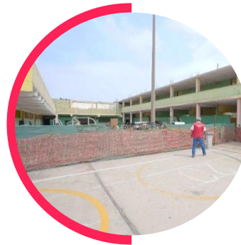
Intervenciones en locales declarados inhabitables por la Municipalidad o en condición de alto riesgo de colapso.
