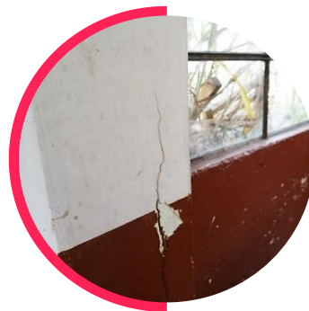
Acciones que puedan ocultar los rastros visibles de daños estructurales.
