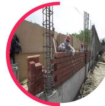
Construcción, modificación estructural y/o demolición de ambientes en el local educativo (incluye cercos perimétricos).
